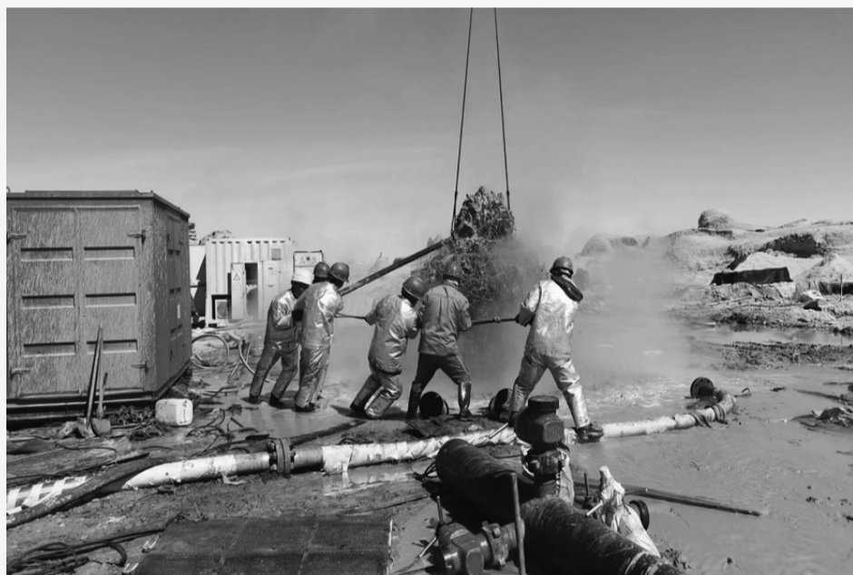
近日,在河北省煤田地质局二队实施的青海省大柴旦工委西台吉乃尔湖北深层卤水钾矿详查现场,鸭ZK0103井正在进行关键作业——拆防喷器与安井口装置。防喷器作为整合钻机最后一道安全屏障,其拆除标志着拆塔工作圆满收官。 刘明杰
