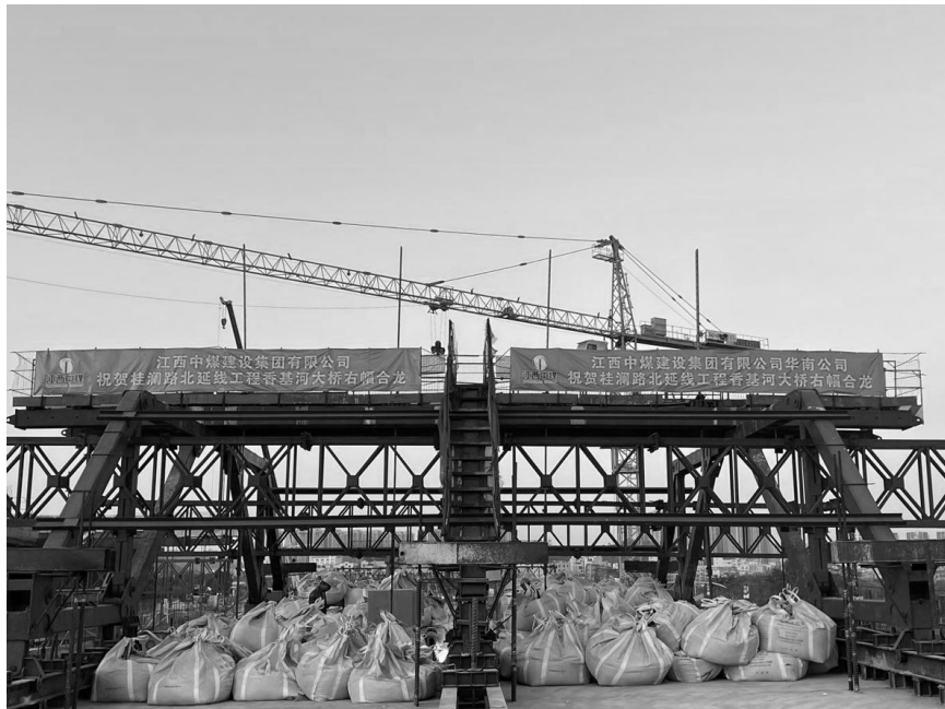
江西中煤建设集团施工的佛山市南海区桂澜路北延线工程是佛山市重点建设项目。日前，该工程香基河大桥右幅顺利合龙，为大面积施工创造了条件。目前，该项目广佛新干线—联滘路工程已正式通车，形象进度已完成68%。戴艾文、康传奇摄影报道
