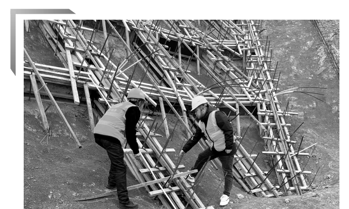
春节过后，陕西天地地质有限责任公司9个在建项目陆续复工复产，有条不紊加紧作业。各项目通过复工复产启动会、工作例会、收心会等形式，对重点工作进行安排，组织开展复工前安全生产检查，全面检查消防设施、临边防护、临时用电等，对施工人员进行安全生产教育和安全技术交底，提高全员安全意识，确保项目有序推进。图为宝鸡市麟游县园子沟矿井与选煤厂项目火车装车边坡治理工程项目现场。 张嘉淇 边成辉 摄影报道
