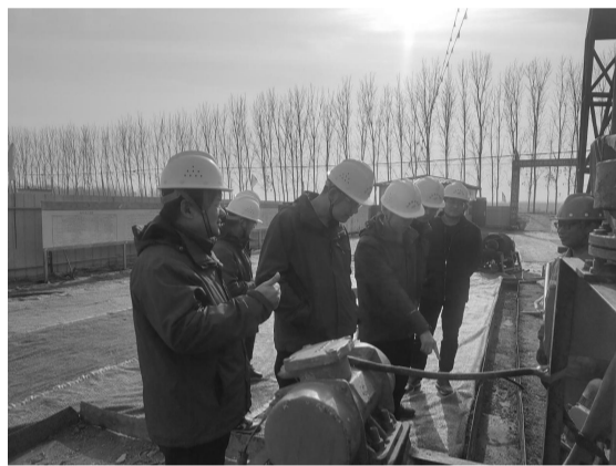
近日,山东省煤田地质规划勘察研究院承担的2024年度省级地质勘查项目—禹城市李屯地区小刘庄铁矿普查LTZK17钻探工程顺利通过开工验收,并举行安全生产“开工第一课”。检查组要求,切实做好冬季“四防”工作,加强隐患排查和设备保养,确保安全生产;严把质量关,确保勘探施工顺利、高效进行;及时、完整、客观记录原始资料,确保真实准确。吕云鹤 摄影报道
