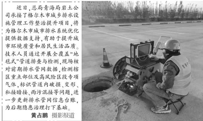
近日,总局青岛局岩土公司承接了格尔木市城乡排水设施管理工程提升项目,将为格尔木市城市排水系统优化提供数据支持,有助于提升城市环境质量和居民生活品质。技术人员通过开展全覆盖“地毯式”管道排查与检测,现场核对前期排水管网数据,检测辖区重点部位及高风险区段专项气体,标识管道内破损、变形、私接暗接、雨污混接等问题,进一步更新排水管网信息台账,为后期隐患治理打下基础。 黄占鹏 摄影报道
