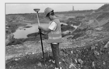
总局江苏局长江环境公司赵宁克服高温天气影响，在宜兴市阳港矿业有限公司金峰山边坡生态修复工程施工中进行边坡高程复核测量。该工程旨在加快矿山地质环境恢复与综合治理，改善周边生态环境与人居环境。 冯文霞
