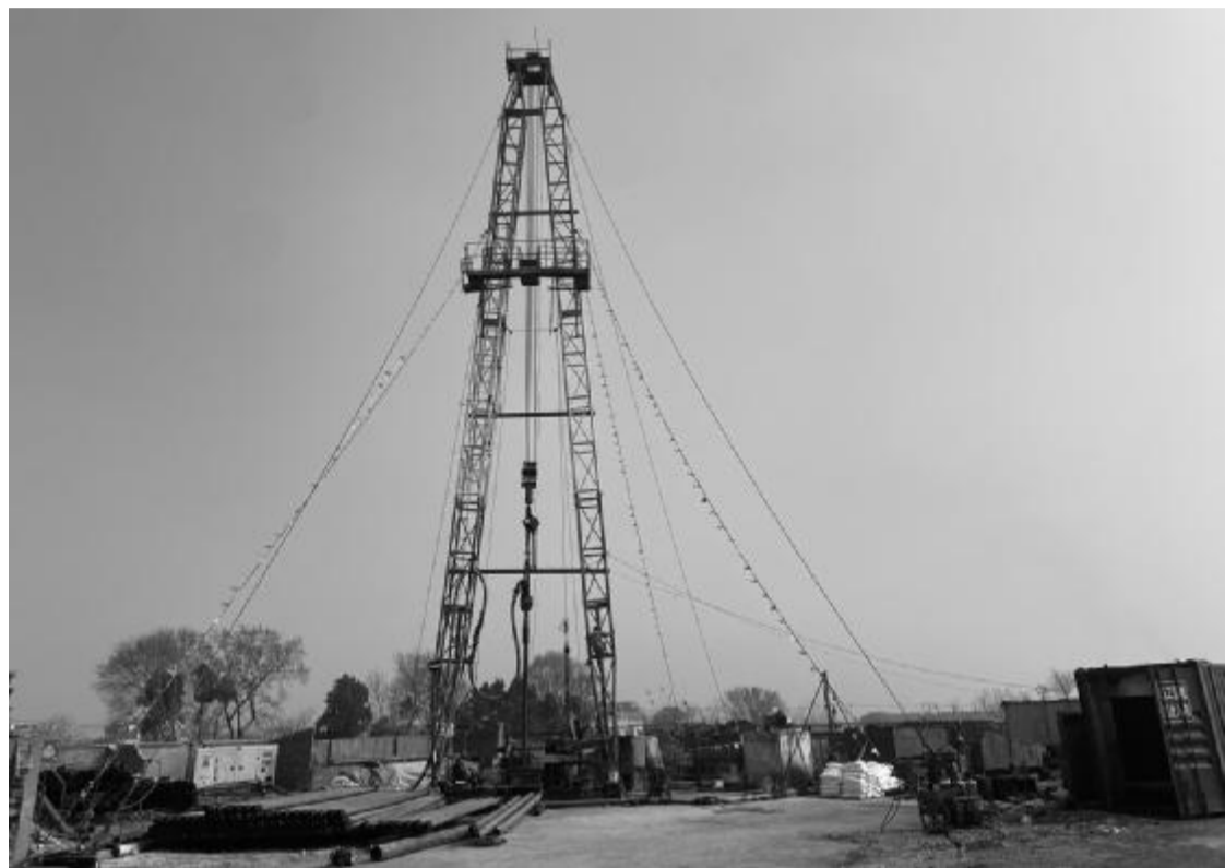
3月11日, 由江苏煤炭地质勘探三队实施的荣炳新1井钻井测井工程开工。三队拟采用定向钻井施工技术, 与地下老腔重新建立测井通道, 进一步对地下腔体空间实施测井评价, 评估地下盐穴腔体容积, 为下一步开展盐腔储能提供决策依据。陈峰 摄影报道
