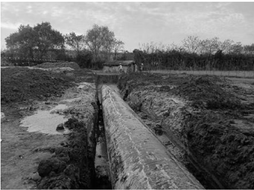
近日,安徽两淮控股集团有限公司两淮建设管道分公司施工的怀远县城西水厂—华润啤酒产业园供水工程——涡河定向钻穿越工程管道回拖成功。这标志着该项目中定向钻穿越工程全面完工。管道分公司负责施工的管线全长约3千米,涡河定向钻穿越是本工程乃至整体工程的重中之重,起到“沟通南北”的作用。 刘之辉 摄影报道
