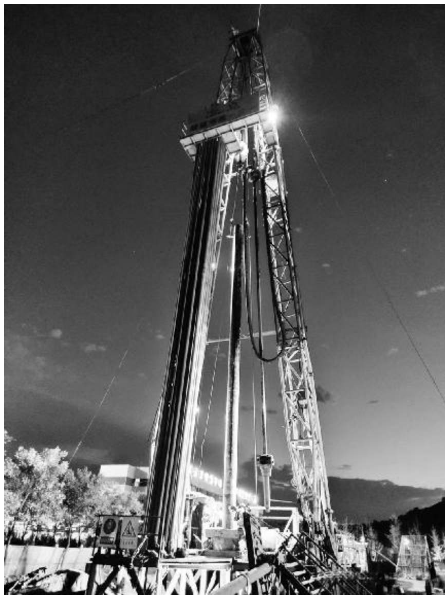
近日，陕西省一三一煤田地质有限公司承担的雅居煤矿强排孔项目完成野外任务。该项目共设计四个强排孔，单孔设计孔深四百八十米，总工作量一千九百二十米。图为下套管场景。尹小兵 黑云飞 摄影报道
